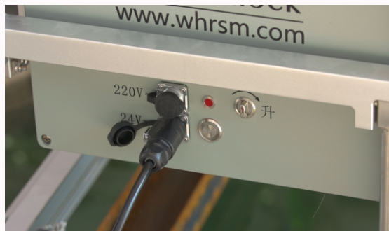
24V蓄电池供电
