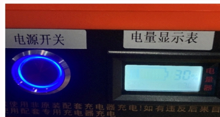
蓄电池电源开关处
